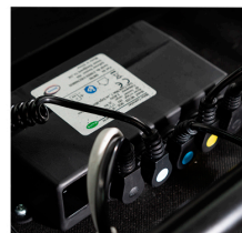
Caja de control conectada sin la tapa
