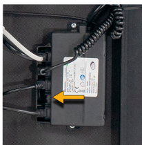
Antes: Caja de control con tapa
